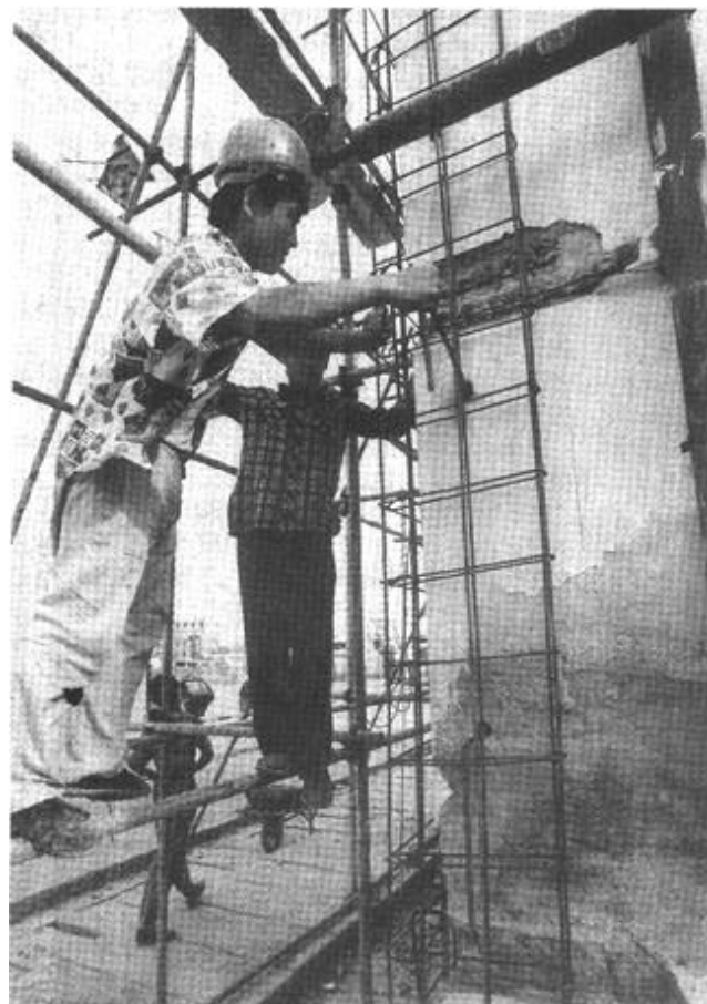
孤岛社区在资金紧张的情况下，千方百计筹措资金，他们对社区内90年代初期建造的居民楼进行抗震加固，使这些楼房的抗震能力大大加强。（刘晓峰 摄）
